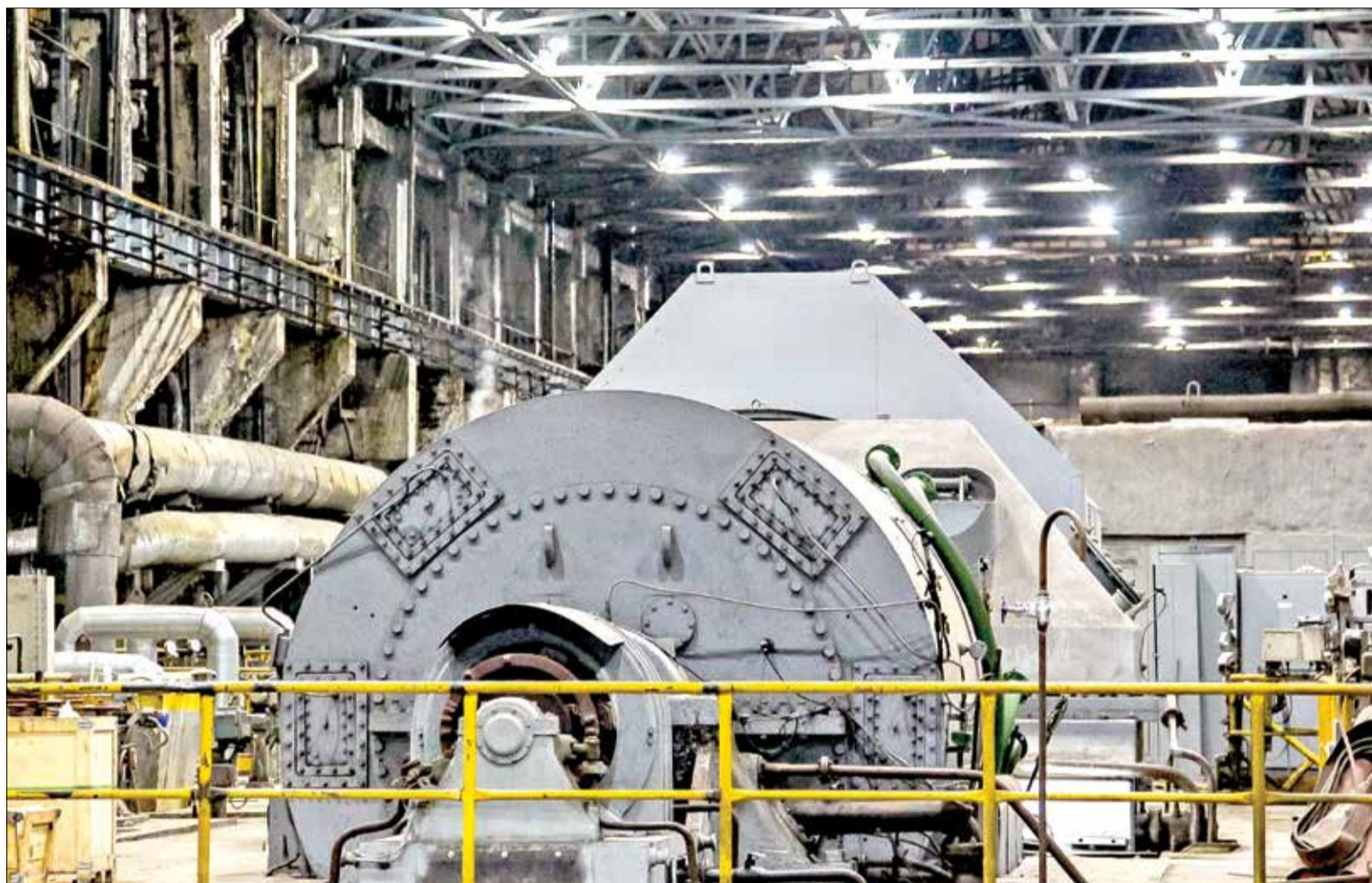
В ТУРБИННОМ ЦЕХЕ первой теплоэлектростанции Архангельского ЦБК
